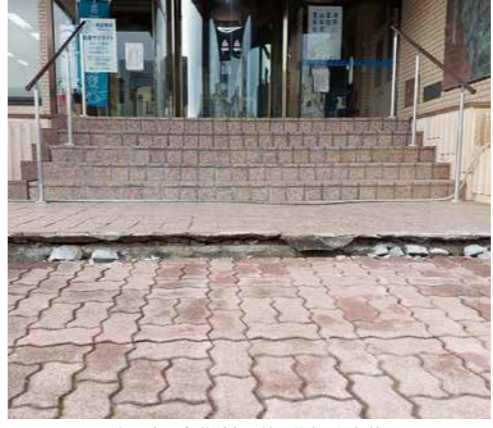
七尾商工会議所玄関前に発生した段差
