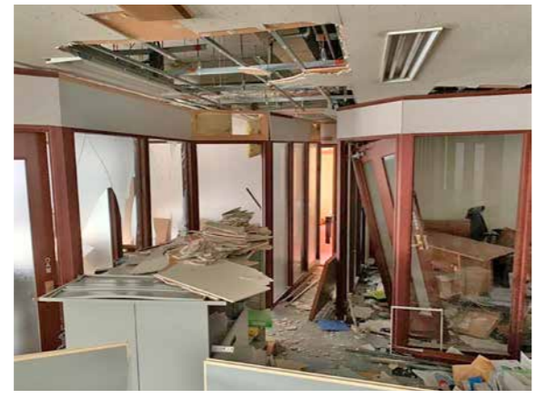
輪島商工会議所内部の破損
